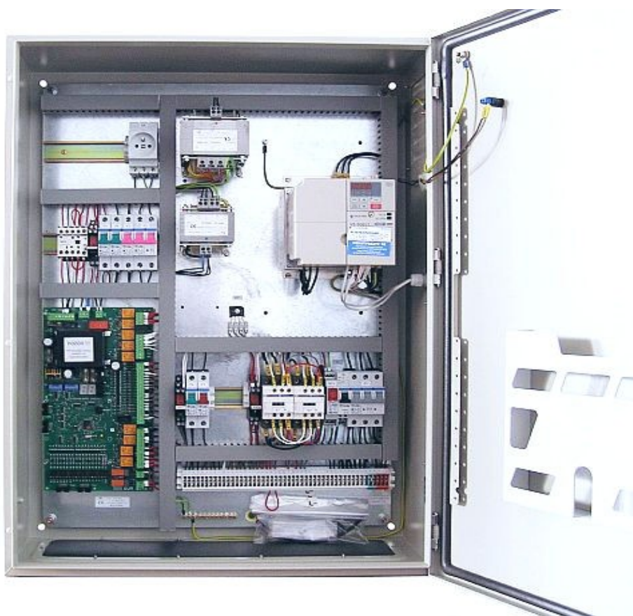
Obr. 73. Pohled na kompletní výtahový rozvaděč
