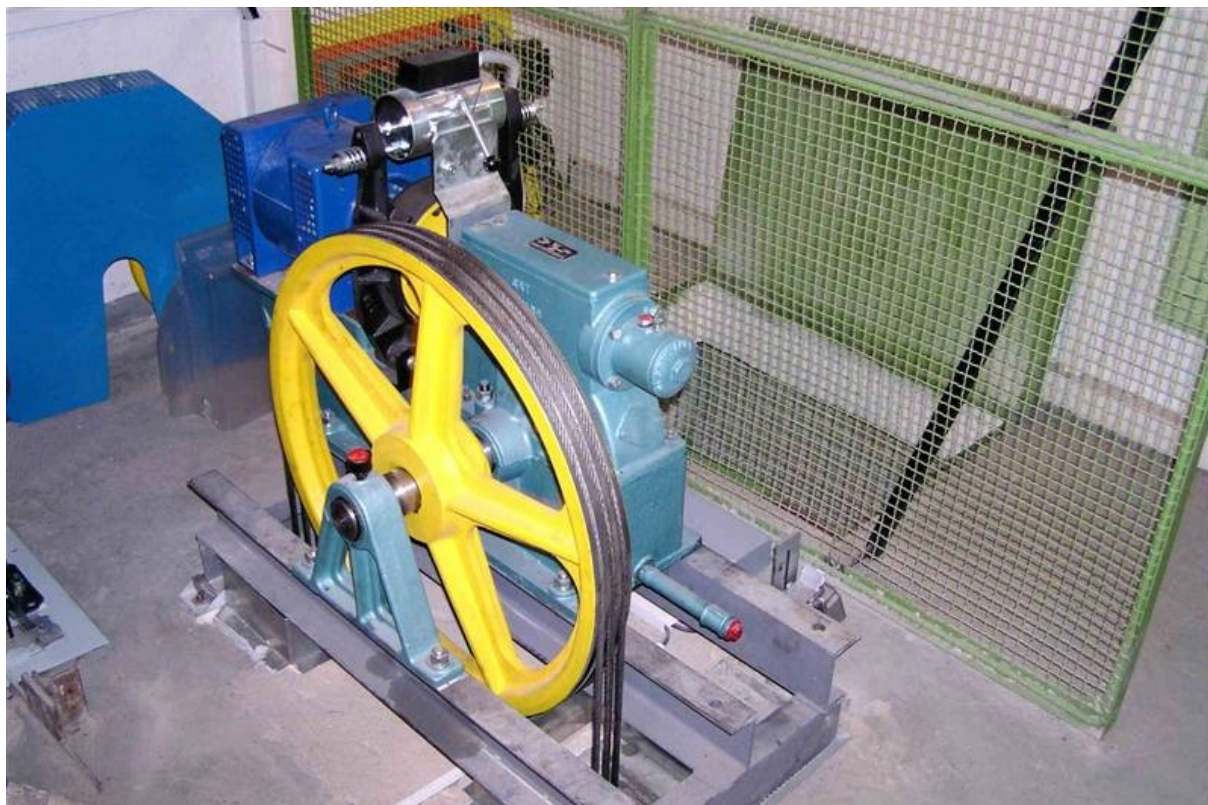
Obr. 19. Lanovnice trakčního hnacího agregátu
